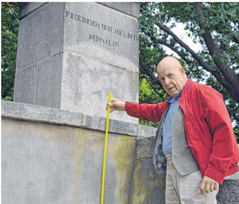
Der Granit sei vergrust, der verwendete Kleber nicht geeignet und das Fundament der Säule nicht tief genug, bemängelt Carlo Wloch.
